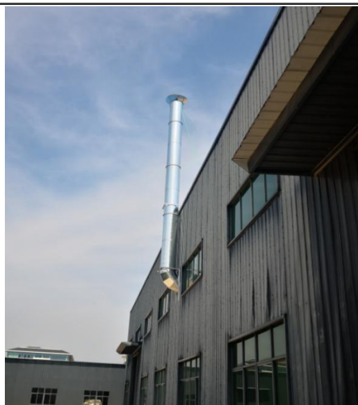
喷粉废气排气筒
